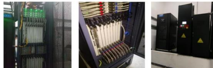
图5 中国电信贵州冷板式液冷路由器试点
