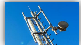
5G基地台 通訊設備
